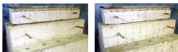
写真-1 破壊状況
