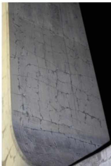
図－１ 構造物の劣化状況
