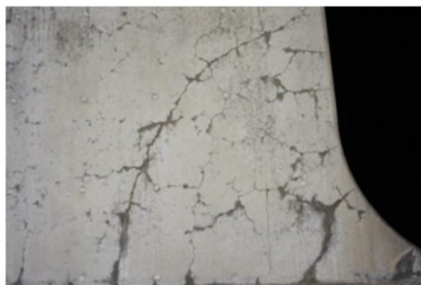
図－２ 構造物の劣化状況
