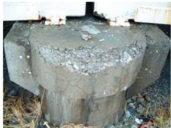
図-1 凍害劣化を生じた橋脚上部 1)
