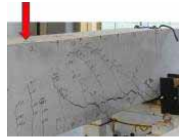
写真-4 Case-2 の破壊状況
