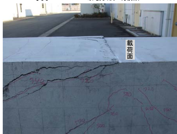
写真-5 MA-2 破壊状況（上フランジ）
