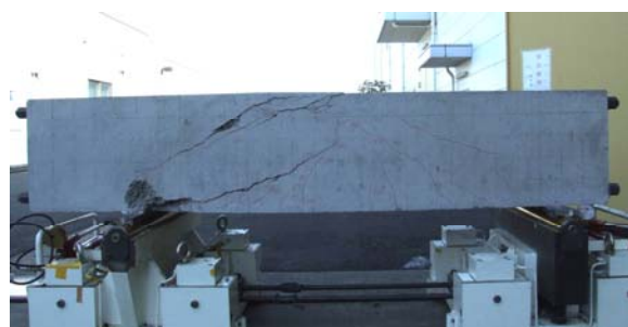
写真-4 MA-2 破壊状況（側面）
