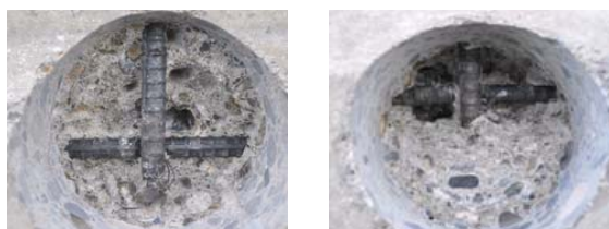
写真-5 鉄筋腐食状況（チタンロッド、無対策）
