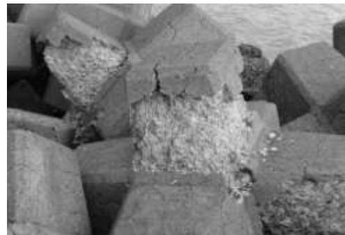
写真-1 コンクリートの凍害および塩害による複合劣化（北海道）
