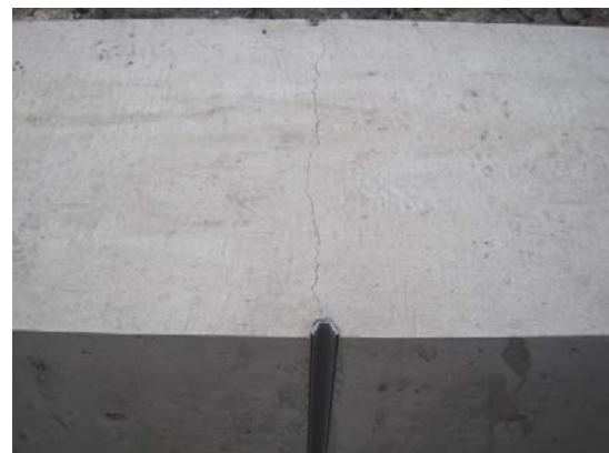
写真-5 ひび割れの発生状況
