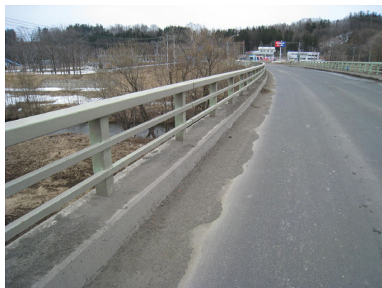
写真－１ 打設から５年後の地覆の状況（３月に撮影）
