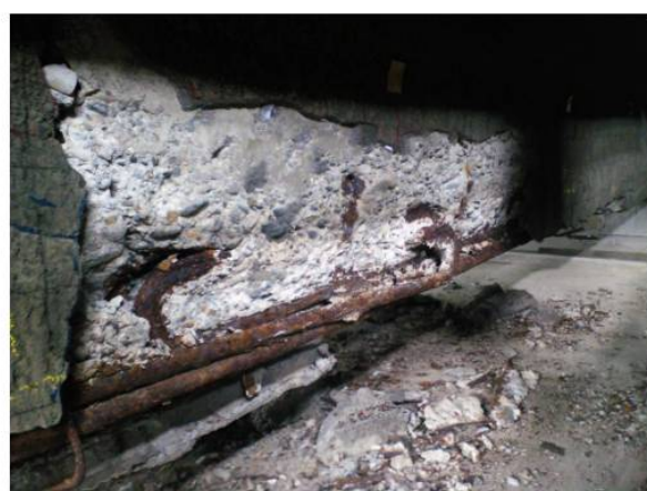
図－１３ 鉄筋継ぎ手露出（中桁）
