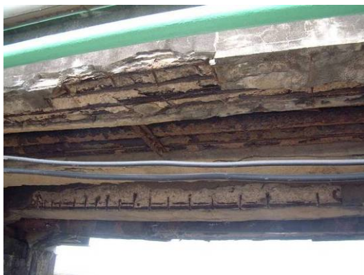
図－３ 能生川橋の劣化状況（桁下面）
