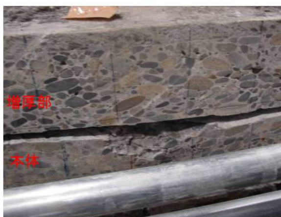
図－１２ 増厚コンクリートの剥離状況（中桁）
