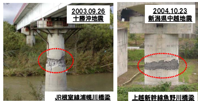
写真－1 鉄道 RC 橋脚の段落し部損傷事例
