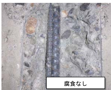
図-14 PC橋 PC2 の鉄筋腐食状況
