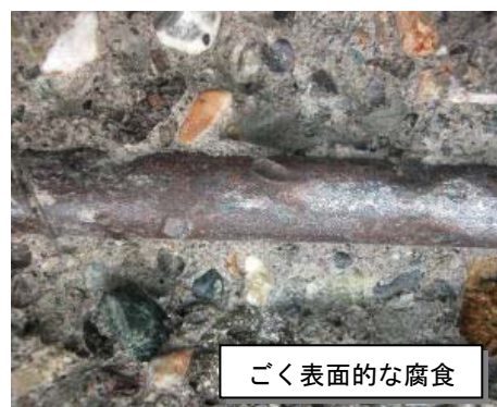
図-13 RC床版橋 RC5 の鉄筋腐食状況
