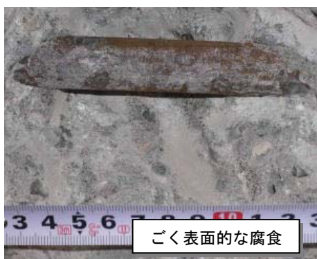
図-12 RC床版橋 RC2 の鉄筋腐食状況
