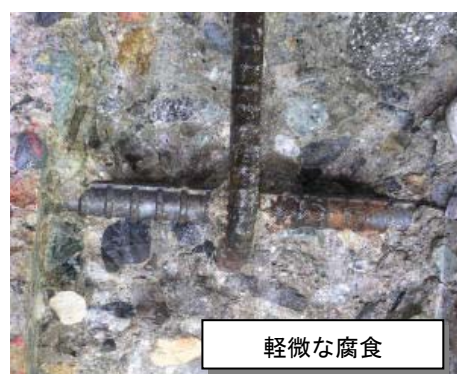
図-15 PC橋 PC5 の鉄筋腐食状況
