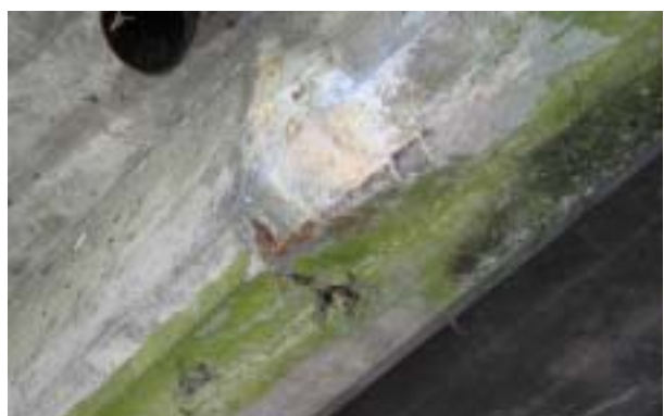
写真 - 2 確認された劣化の例（遊離石灰）
