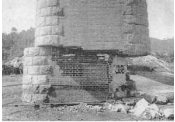
写真-3 橋脚の切断・横ずれ 3)
