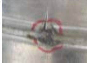
CR4-1 鋼板の破断
