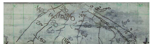
写真－３ NSNG-40-S ひび割れ状況
