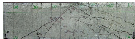
写真－５ LSN-40-S ひび割れ状況
