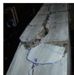
No. 1 RC-0.24-S 上面割裂ひび割れ
