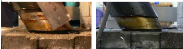
(a) - 9 サイクル (b) + 10 サイクル 写真 - 5 プレースの基礎梁側の接合部
