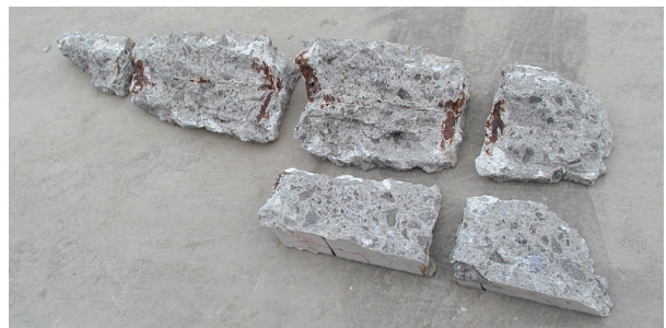
写真－4 上縁コンクリートのブロック化した剥離片
