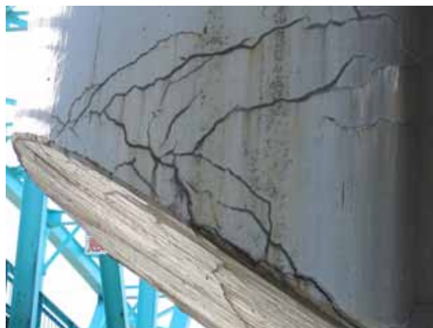
写真 - 1 橋脚コンクリートの ASR 劣化
