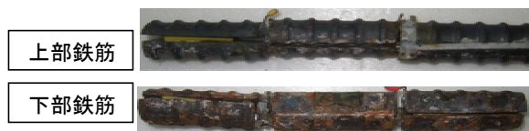
写真-2 鉄筋腐食状況 (No. 4)
