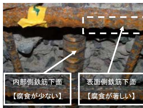
写真-1 鉄筋腐食状況(例)
