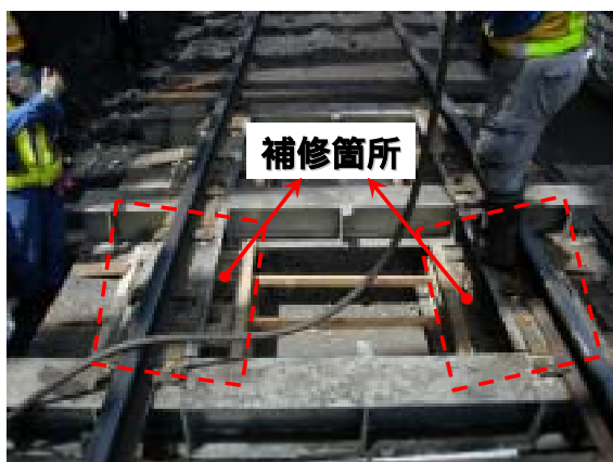
図 - 8 補修箇所の施工前状況
