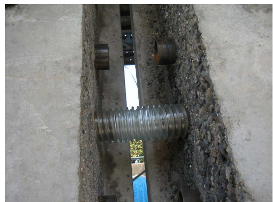
写真－4 フレキシブルホース接続状況
