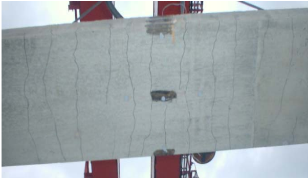
写真-2 ひび割れ(スラグ骨材)
