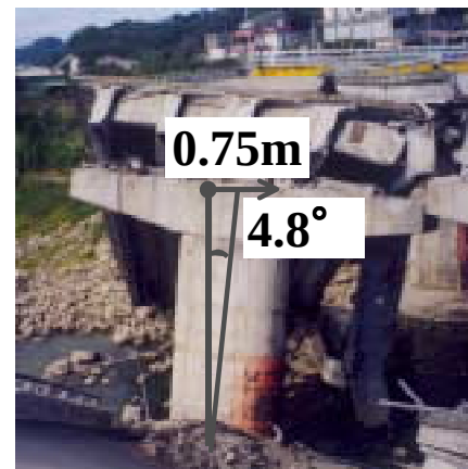
写真-2 P2 橋脚の橋軸直角方向への回転
