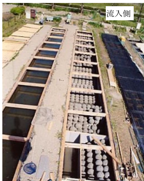
写真-2 PoC ユニットの設置
