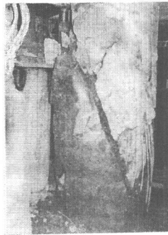
写真-1 地震による杭のせん断破壊例
