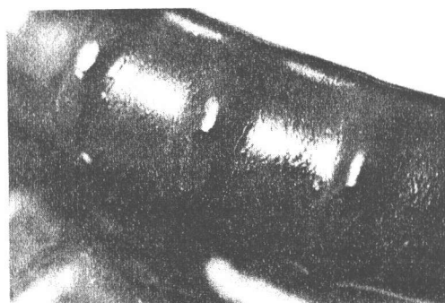
写真-1 塗膜のひびわれ
