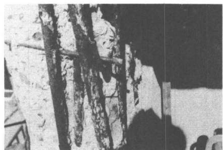
写真3 西北袖壁上部梁定着筋の腐蝕
